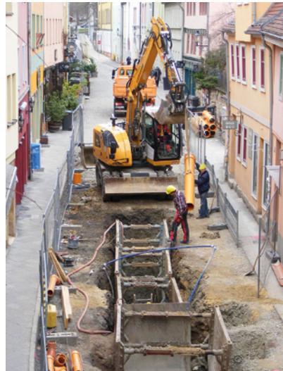
Die Bauarbeiten in der Wagnergasse gleichen im engsten Teilstück einem Nadelöhr. Die Breite der Wagnergasse beträgt an dieser Stelle etwa 6 Meter, 1,20 Meter davon blieben für die Fußgänger.
